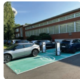
Installation de bornes de recharge et remplacement des véhicules par des modèles hybrides.
